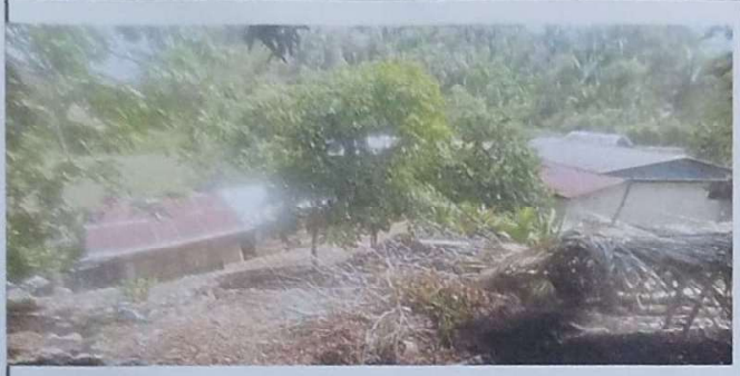
Foto 1: se observa el techo de la cocina, dirección y baños en mal estados donde se laminas troqueladas
