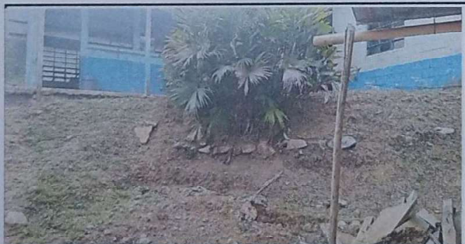
se observa parte de la tierra que va derumbandose ( contruccion de muro de contencion)
