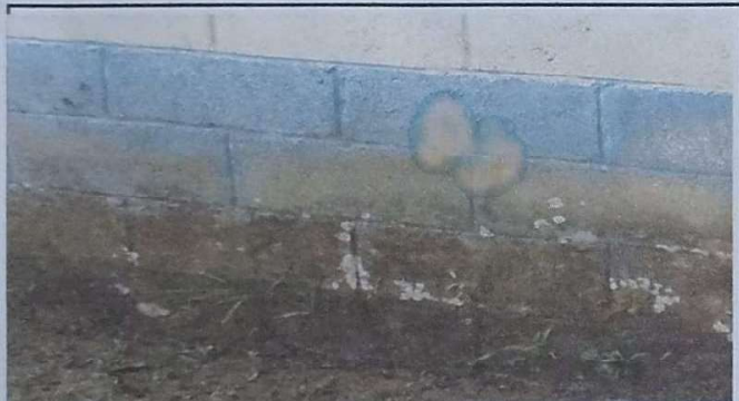
Foto 3: se observa el deterioro de pintura de la escuela, Baños, Direccion.
