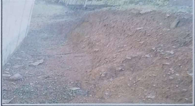
Foto 2: Se observan riesgo de derumbe donde se necesira muros de contencion minimo 20 metros de largo por 1.25 mts de altura.
